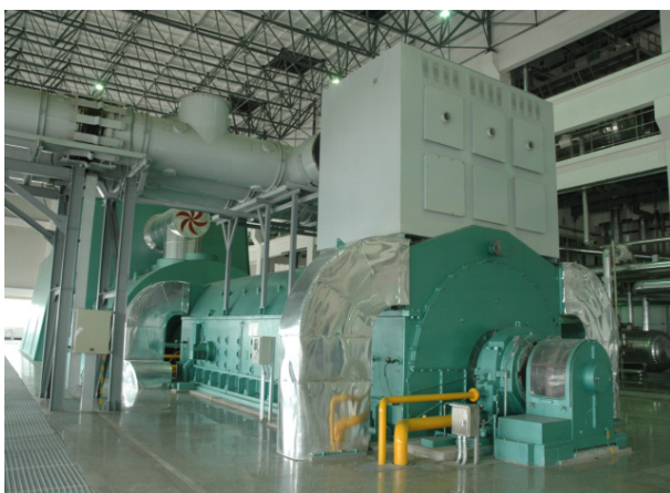
图 1 电厂运行的 330MW 空冷汽轮发电机
