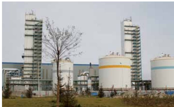
在中华人民共和国曹妃甸安装的空气分离设备
