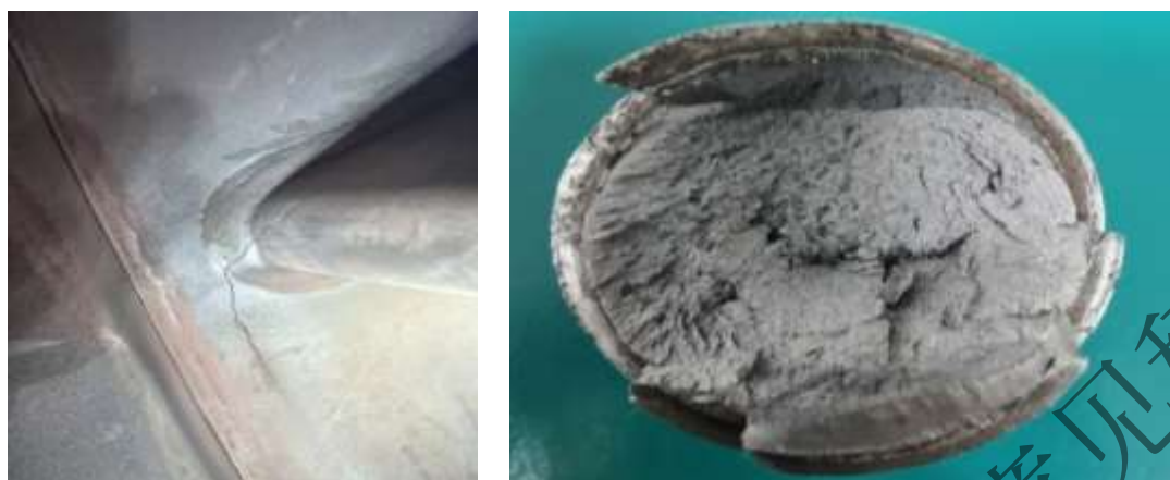
a) 不锈钢结构件断裂
